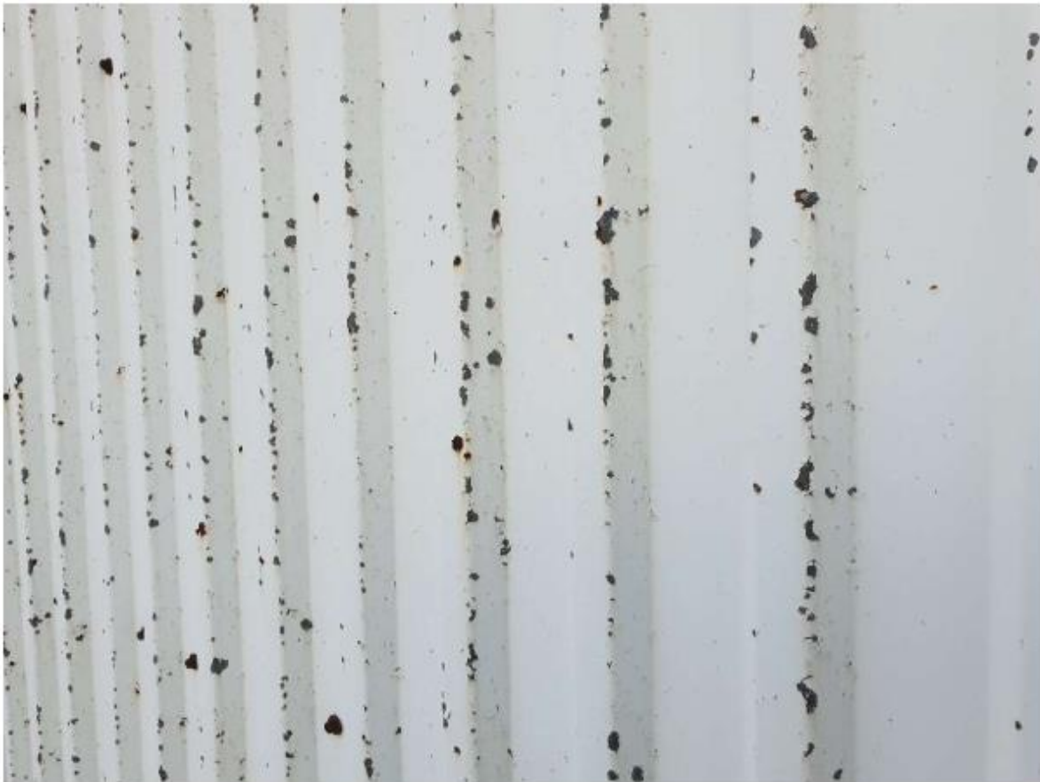
MYND 4.24 Mynd tekin af norðurhlið geymslu sem stendur suðvestan framkvæmdarsvæðisins. Greinilegar skemmdir sjást á klæðningunni sem líklega má rekja til jarðvegsfoks frá efnistökusvæði
